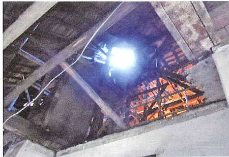
本館中央屋根部分、煙突落下
