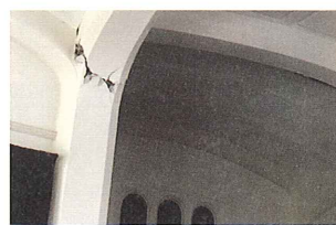
礼拝堂の亀裂
