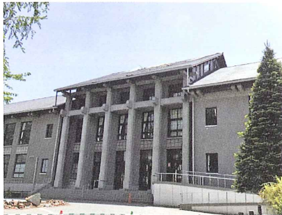
4月16日の本震で崩落した本館シンボルマークの2本の煙突
