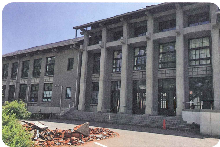
本館屋根から落ちた煙突。「子どもがいない時間で良かった」
