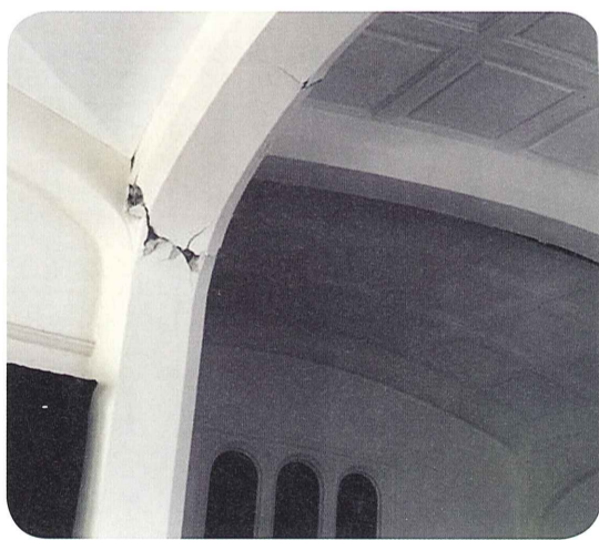
礼拝堂の亀裂
