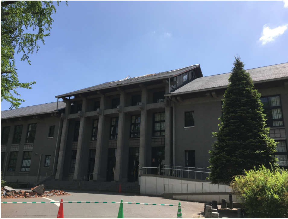
4月16日の本震で崩落した本館シンボルマークの2本の煙突
