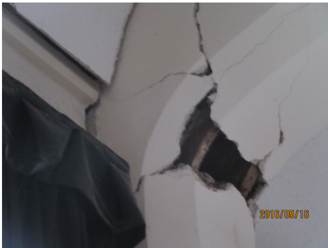
③礼拝堂、アーチ部分の破損
