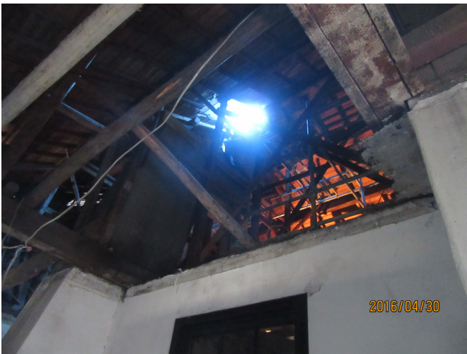
①本館中央屋根部分、煙突落下
