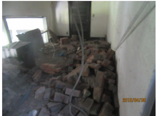
④礼拝堂、2階ギャラリー部分。煉瓦が倒壊
